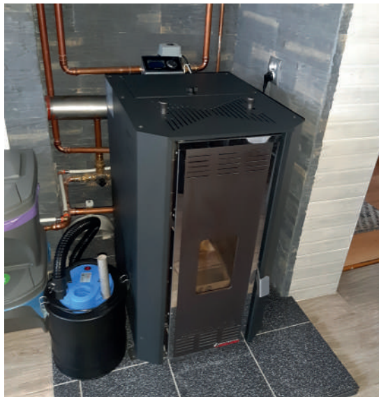
Ekologiczny piec zainstalowany w budynku wielorodzinnym w Sztumskiej Wsi.
